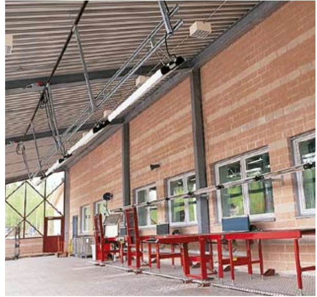
Для наилучшего эффекта приборы лучше располагать не над головой, а с некоторым смещением, для того, чтобы большая часть излучения поглощалась телом человека. В данном случае для равномерного распределения тепла с одной стороны под балками перекрытия размещены приборы IR, а с другой, на стене здания обогреватели CIR.
