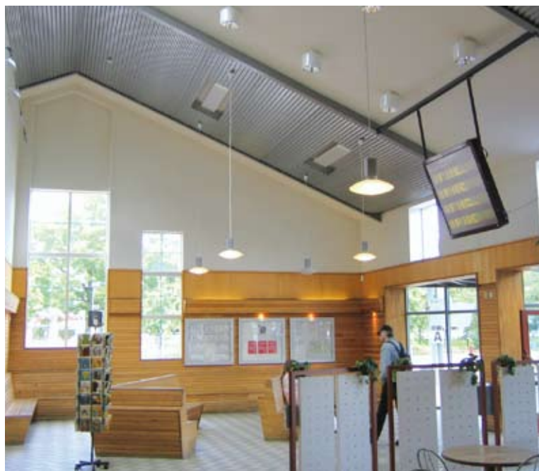
Потолочная установка приборов дает возможность использовать объем помещения максимально полно.
